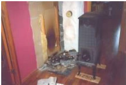
Brann bak brannmur problematikken.
