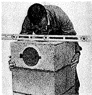
Fig. 1 Vanlig fundament (h) mures av Leca-blokker. Feielukeelementet vatres opp, mursnorner loddes opp og festes.
