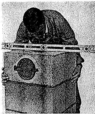
Fig. 1 Vanlig fundament (h) mures av Leca-blokker. Feielukeelementet vannes opp, mursnorner loddes opp og festes.
